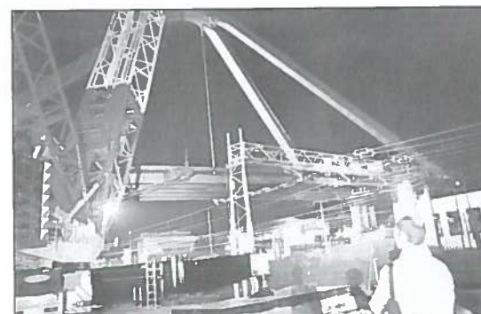
Figura 23 - Fasi del varo. l'impalcato e sopra ai binari prima di esser calato
