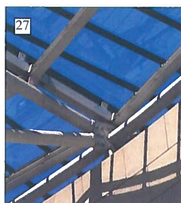
Fig. 27. Museo d'arte moderna e contemporanea, Rovereto. Dettaglio dell'appoggio perimetrale delle travi reticolari.
