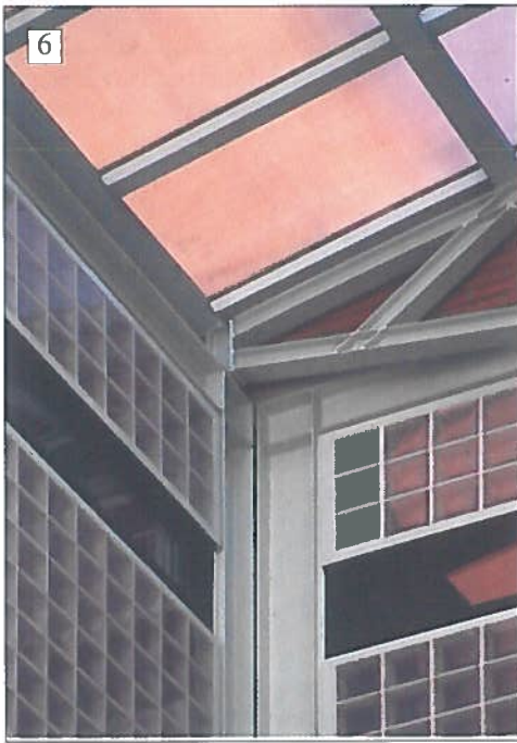
Fig. 6. Centro Cinque Continenti, Lugano. Dettaglio della copertura e del sistema dei ballatoi in corrispondenza della soluzione d'angolo.
