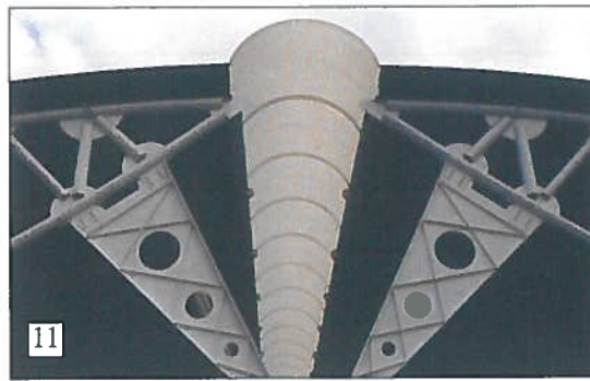
Fig. 11. Le Torri a Cintoia, Firenze. Dettaglio del lucernario realizzato in corrispondenza del punto di contatto delle due falde.
