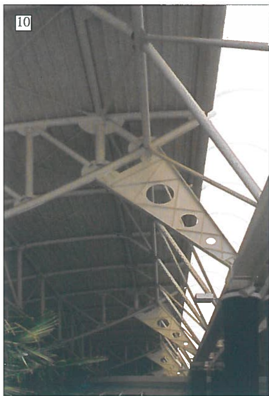
Fig. 10. Le Torri a Cintoia, Firenze. Vista da sotto della struttura metallica in corrispondenza del lucernario centrale.
