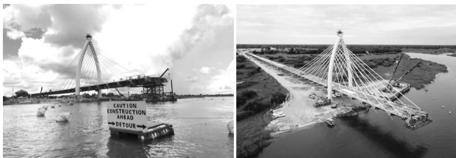
Fig. 10. Fase di montaggio in alveo: a sinistra la fase di movimentazione ed installazione del concio mediante il pontone, a destra la fase di tesatura della coppia di stralli
