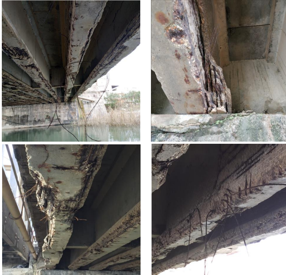
Fig. 1. Degrado delle travi rilevato alla prima ispezione del ponte sul torrente ASA nel comune di Pontecagnano (SA)
