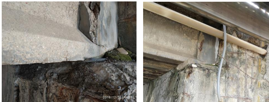
Fig. 2. Degrado delle spalle in prossimità degli appoggi
