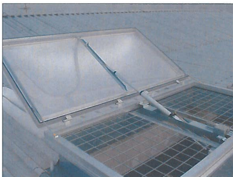
Tecnocupole Pancaldi srl - Evacuatori di fumo e calore Free Smoke, installati nel cantiere Fiere di Padova. Il tamponamento è realizzato con pannello cieco per escludere l'immissione di luce naturale dall'alto.
