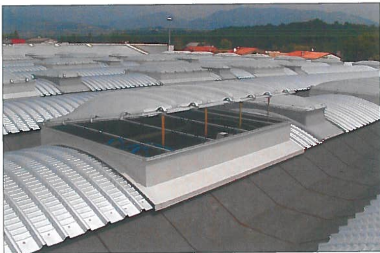
Caoduro® Spa - Lucernari componibili 035 Fx a doppia parete apribili elettricamente, ed evacuatori di fumo e calore inseriti su copertura Cover Link dimensioni Luce 250 cm.
