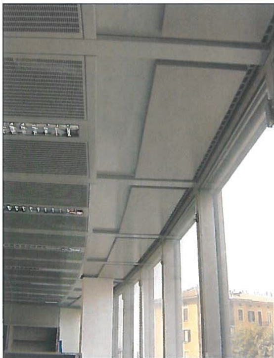
Fig. 26. Vista degli impianti integrati nel controsoffitto.
