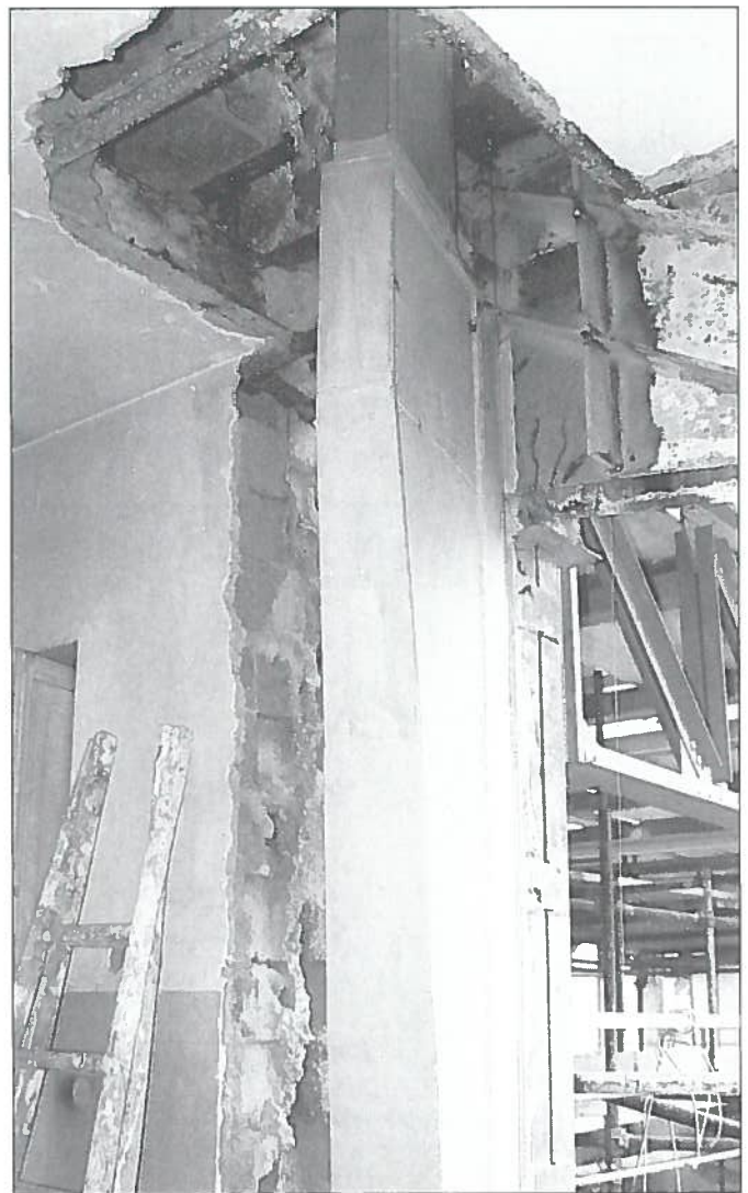
32. Mensola in acciaio per trasferire il carico dell'impianto di condizionamento al montante della capriata, compensando l'eccentricità prodotta dal nuovo appoggio superiore. 32. Steel cantilever for transferring the load of the air conditioning installation to the vertical member of the truss, by compensating the eccentricity due to the new upper support.
