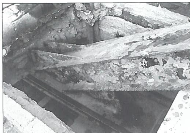
8. Condizioni di corrosione di un nodo alla base della membratura inclinata di una capriata superiore, anche nella zona inglobata nello spessore del masso di copertura.
