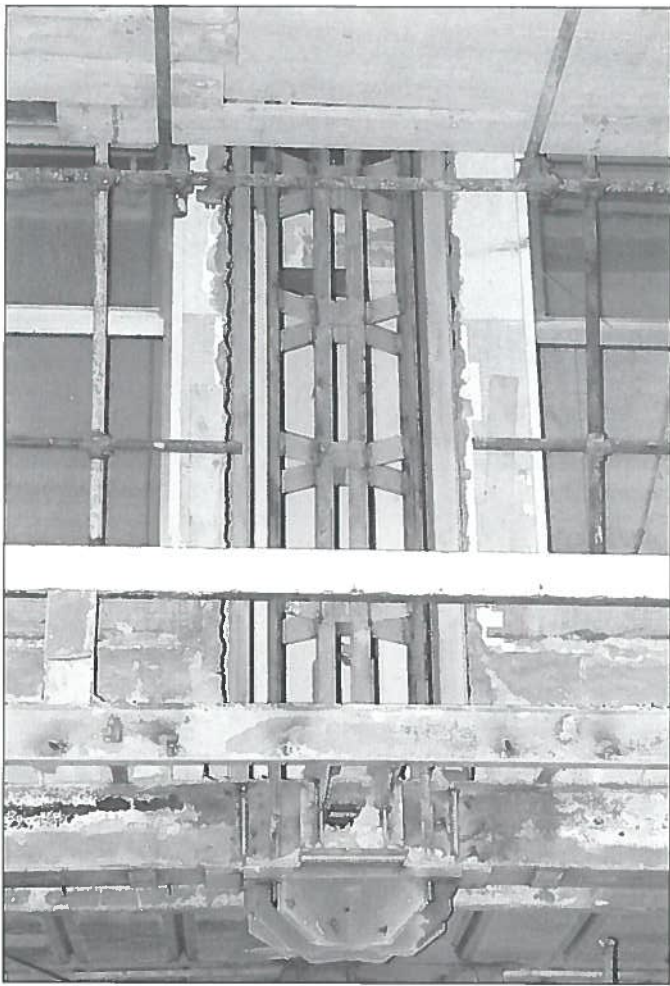
20. Il collegamento dei quattro tubi al profilato avviene mediante piattini distanziatori ubicati in corrispondenza dei calastrelli; è visibile inferiormente la piastra di ancoraggio in corrispondenza del secondo livello.
