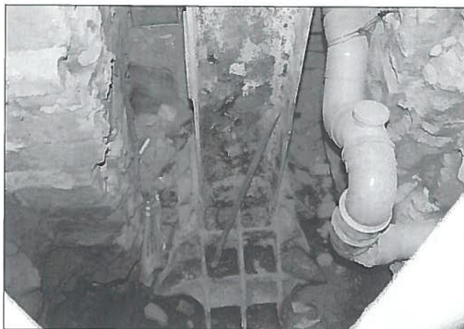
12. Condizioni di corrosione della base di una colonna perimetrale di un telaio trasversale.
