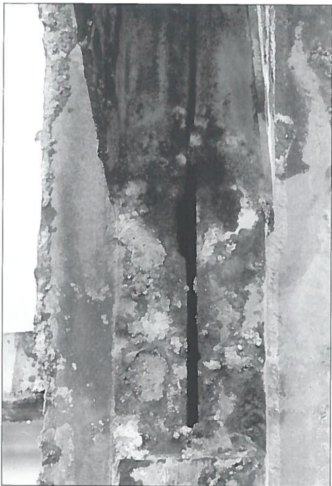
11. E' evidente la riduzione di sezione resistente dovuta al fenomeno corrosivo.
