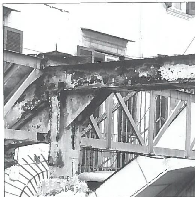
10. Dopo l'eliminazione dello spessore di rivestimento protettivo, tutte le membrature delle capriate di copertura hanno presentato un intollerabile stato di corrosione delle superfici.
