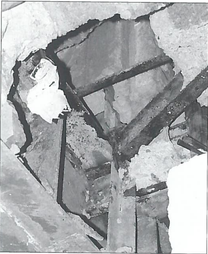
6. Come si presenta un nodo di telaio in acciaio completamente saldato in opera. 6. The condition of a steel frame joint completely built-up by welding.
