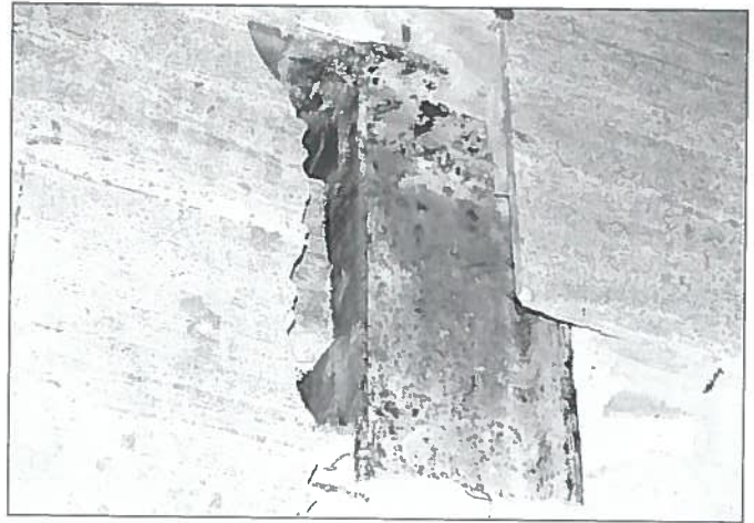
5. Saggio per evidenziare le condizioni della struttura in acciaio: si nota un diffuso inizio di corrosione. 5. Assay that shows the condition of the steel structure: the corrosion is widely spreading.
