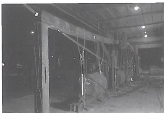
Figura 6 - Capriata con carico prossimo a quello di collasso.
