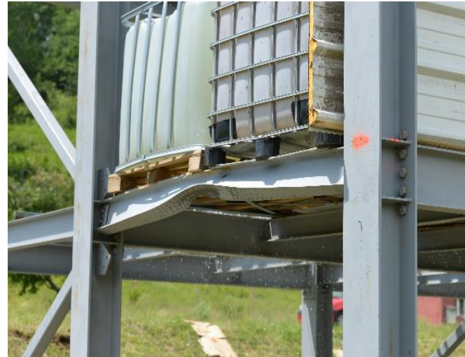
Effetto secondario dell'esplosione: Trave danneggiata dai 'detriti' della colonna
