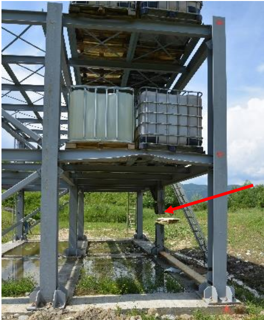
Effetto primario dell'esplosione: La colonna tranciata
