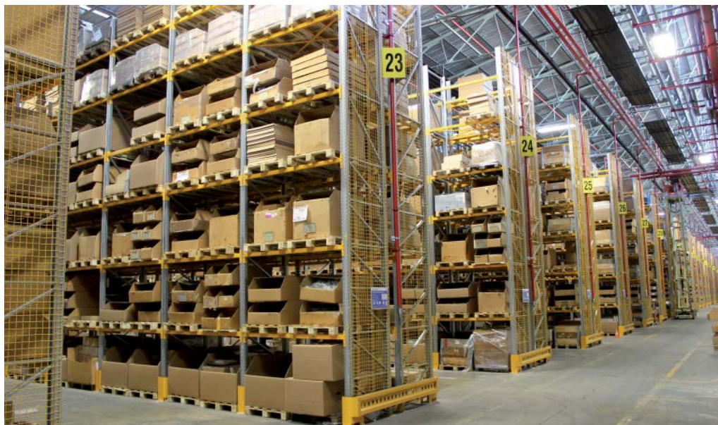
Fig. 6 - Magazzino porta pallet in zona sismica con impianto sprinkler anti-incendio integrato. Si notano la tralicciatura di spalla a passo ridotto e la controventatura orizzontale al quinto livello di carico
