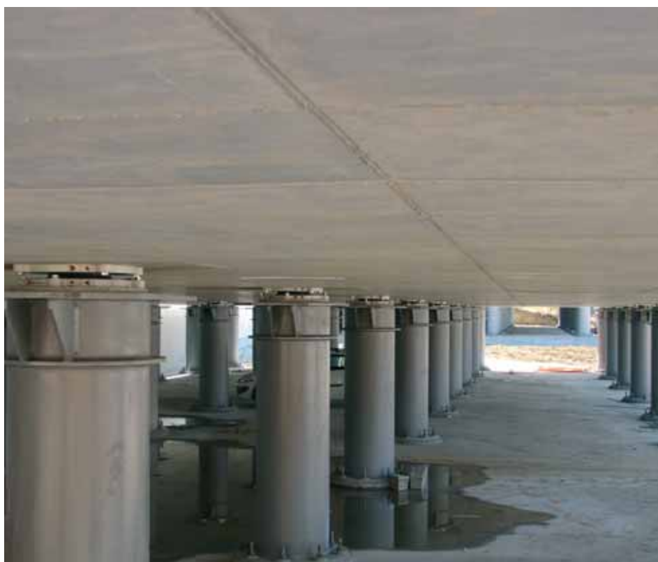
Fig. 3 - Isolatori a scorrimento a superficie curva installati in uno degli edifici del Progetto C.A.S.E. a L'Aquila
