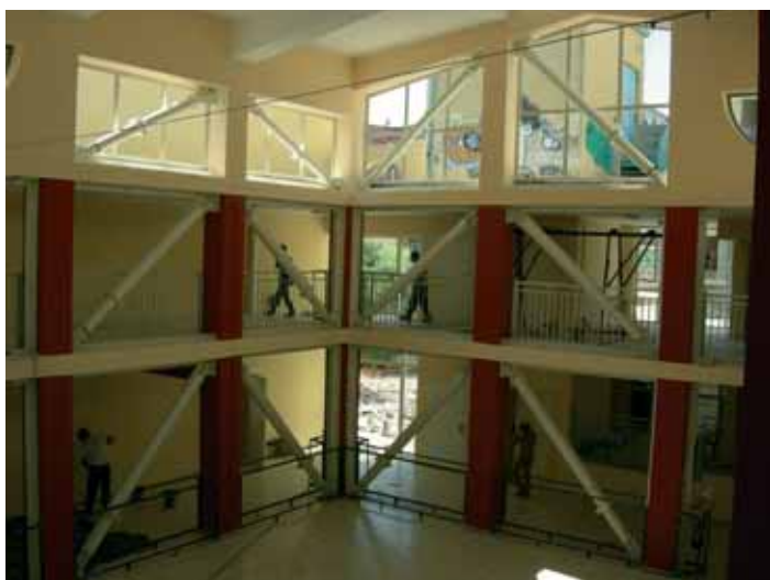
Fig. 1 - Dissipatori isteretici assiali ad instabilità impedita utilizzati per il miglioramento sismico della scuola Cappuccini a Ramacca (CT)
