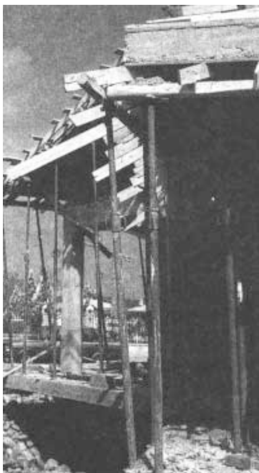
Fig. 1 - Realizzazione molto approssimativa, ma non rara, di un sistema di puntellazione (da "Costruzioni Metalliche" n. 5/2002)
