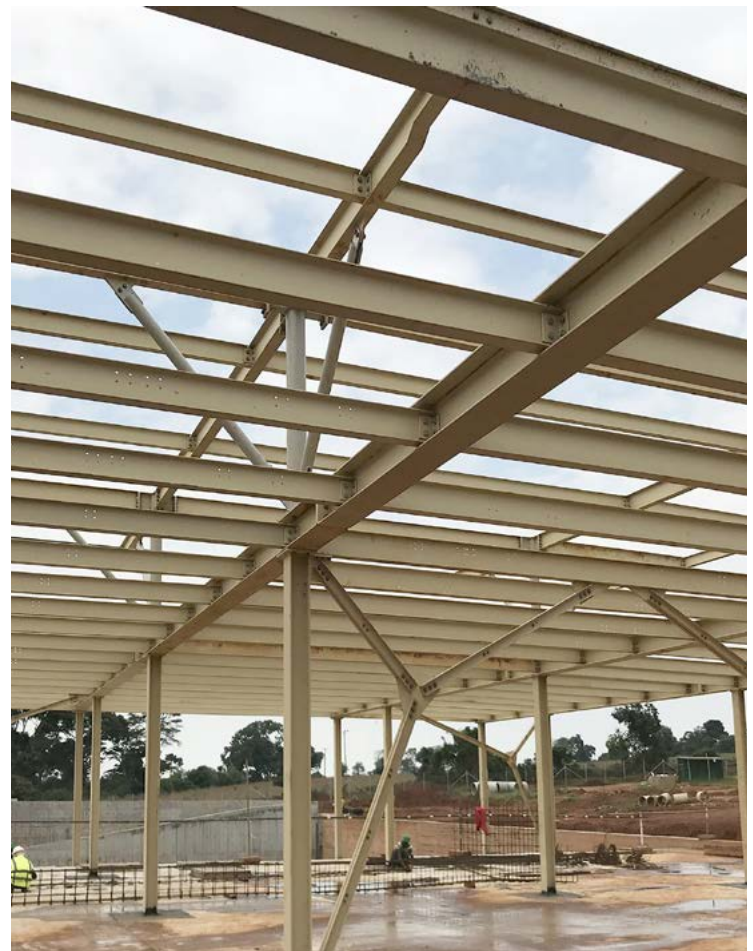
Fig. 46 - Costruzione della struttura di acciaio del corpo centrale. © Emergency NGO Technical Department
