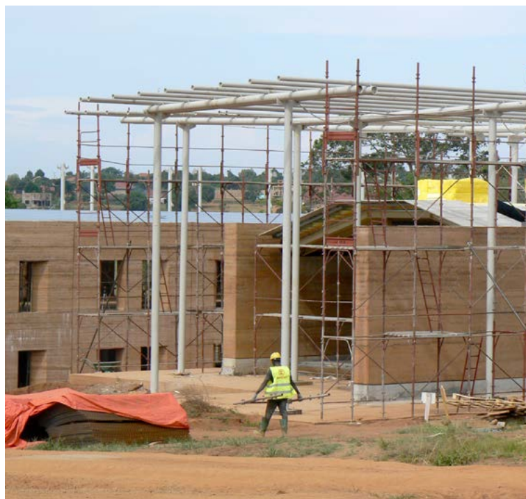
Fig. 43 – Costruzione del sistema di ombreggiamento dell'ala sud in corrispondenza del fronte ovest. © Emergency NGO Technical Department
