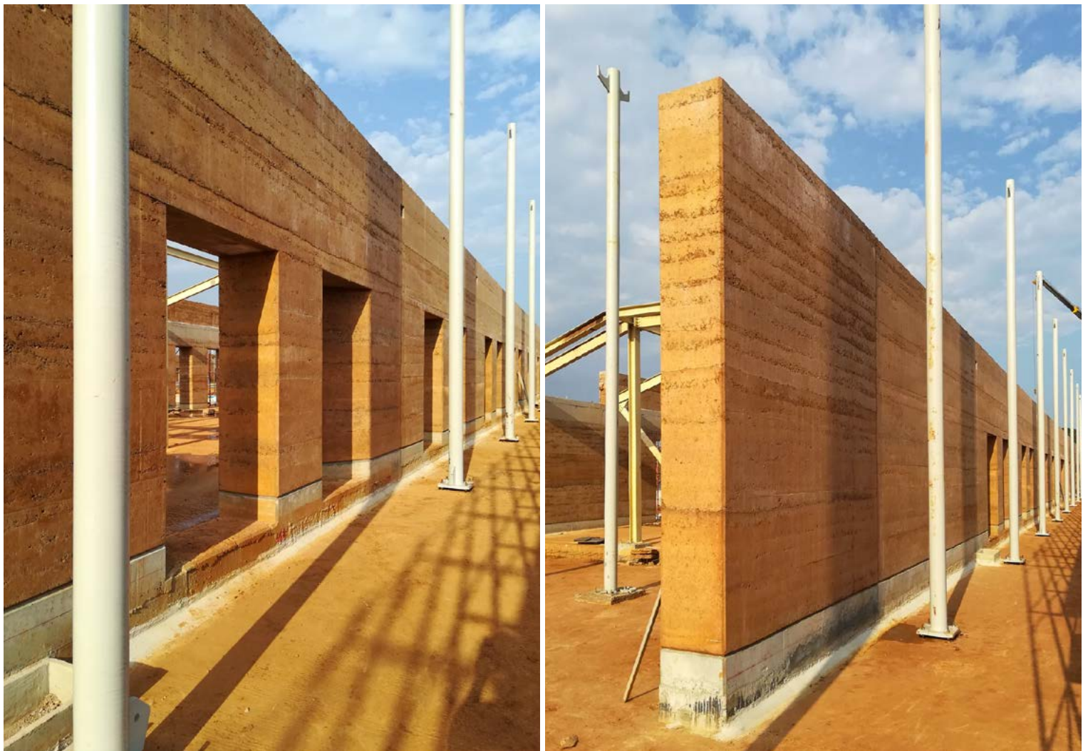
Figg. 24-25 – Scorci delle murature in pisé durante il montaggio delle colonne esterne della struttura di ombreggiamento della copertura dell'ala sud. © Emergency NGO Technical Department
