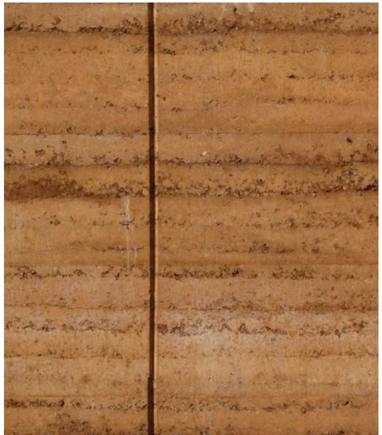
Fig. 23 – Dettaglio della linea di induzione delle fessurazioni delle murature in pisé. © Massimiliano Milan
