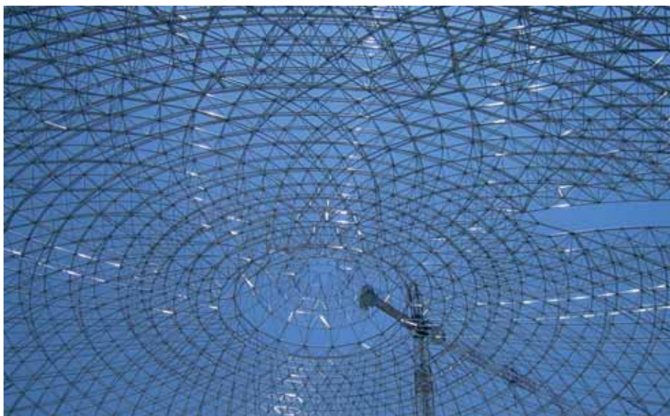
Fig. 3.4 - Struttura da interno
